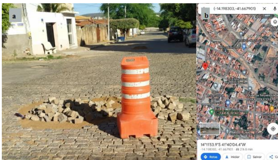
Figura 5: (a) Danos causados em via de rolamento próximo a um posto de visita (PV), localizados na rua Jorgeane Silva Mende, 120, Santa Teresa, Brumado/BA, coordenadas geográficas 14^{\circ} 11' 53,9'' S – 41^{\circ} 40' 04,4'' W, data do registro 26/12/2023 às 16h 25min. (b) Imagem de satélite da localização do registro:
