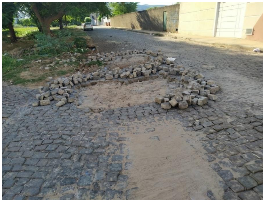
Figura 4: Danos causados em via de rolamento localizados na rua Jorgeane Silva Mende, 115, bairro Santa Teresa, Brumado/BA, coordenadas geográficas 14^{\circ} 11' 53,9'' S – 41^{\circ} 40' 04,6'' W. Em 26/12/2023 às 16h 24min:
