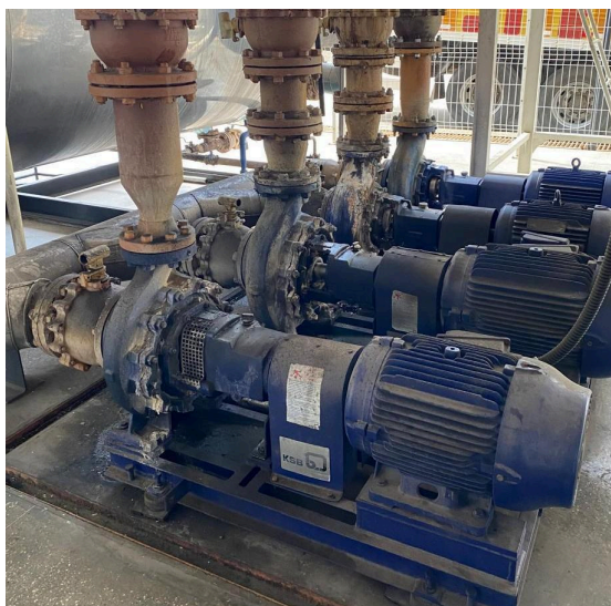
Figura 3 - Conjunto de motobombas.
