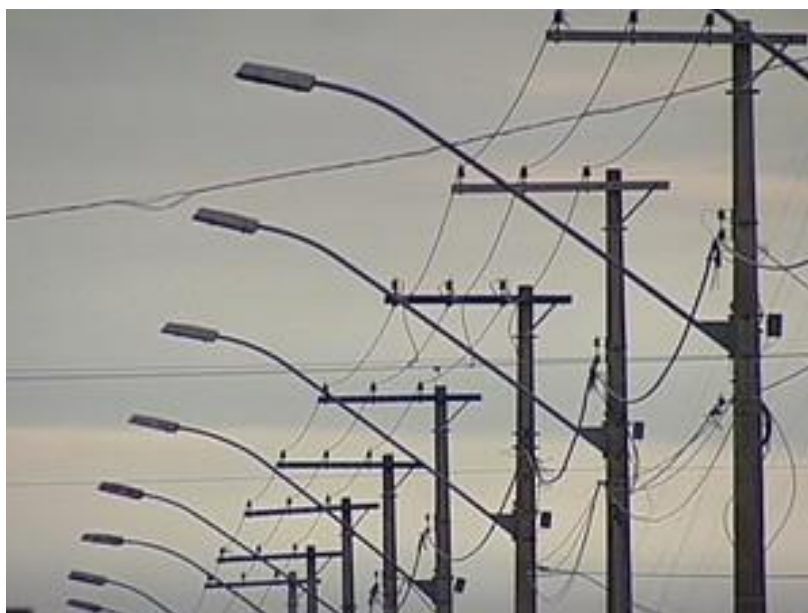
Figura 2.2 - Rede de distribuição aérea convencional.
