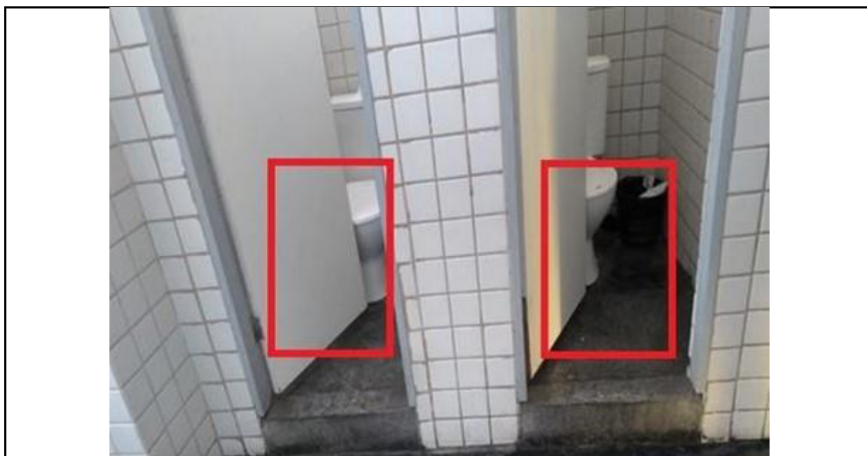
Figura 24 - Detalhe do segundo andar da falta de espaço para circulação
