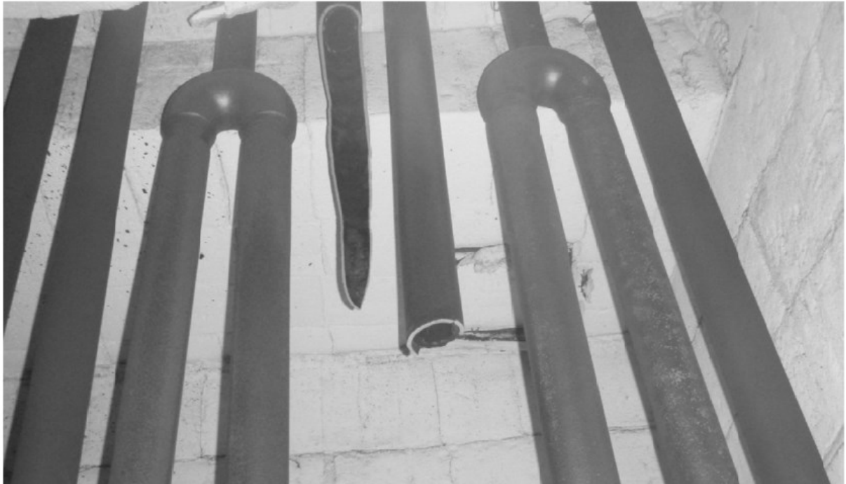
Figura 12 - Fratura frágil nos tubos da serpentina, por conta da carburização e tensões geradas no resfriamento do forno
