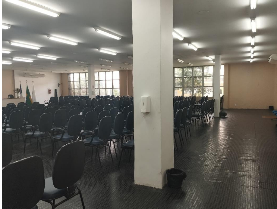
Figura 18 - Piso do auditório apresentando sinais de desgaste
