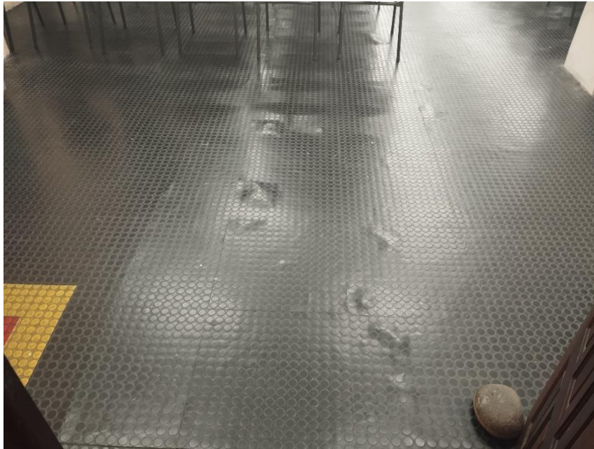
Figura 19 - Piso do auditório apresentando sinais de desgaste
