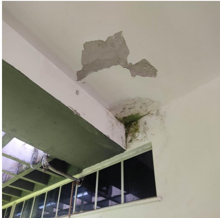
Figura 20 - Infiltração na laje do auditório
