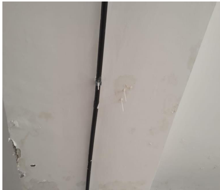
Figura 17 - Presença de estalactite na viga
