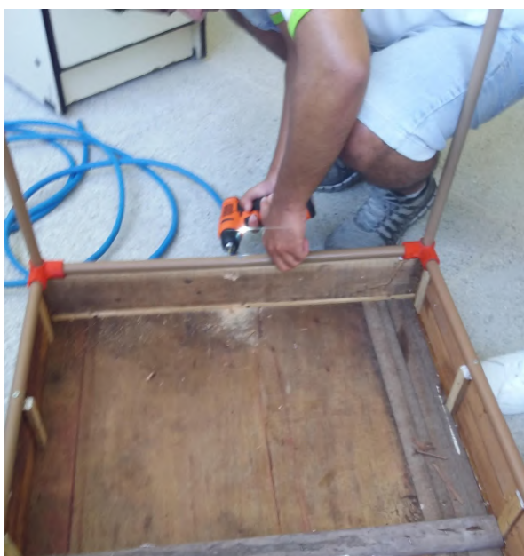
FIGURA 49- Furo da passagem da mangueira
