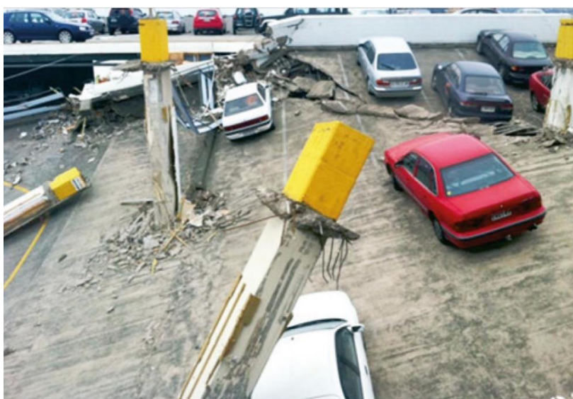
FIGURA 3 – Ruptura por punção em pavimento com lajes lisas. Fonte: IBRACON (2015)
